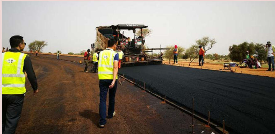
Construction d'une autoroute par la China Road and Bridge Corporation (CRBC) à Thiès, au Sénégal. Crédit : Yifan Yang.
