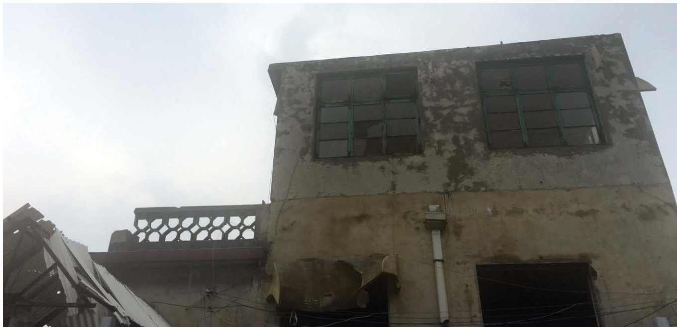
Uma residência “nail house” semidestruída em uma vila urbana na China Oriental, em junho de 2017.
